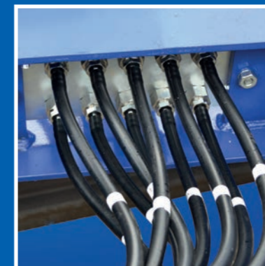
Anschluss zur Steuereinheit der Weiche
